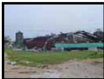
Fig. 13 Afectación en naves de crianza.
