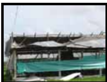
Fig. 12. Afectación en techos.
