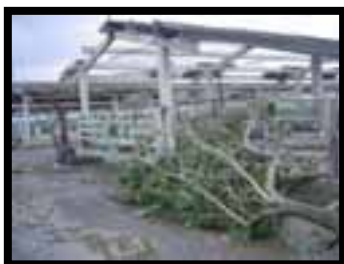
Fig. 2. Daños en instalaciones ganaderas.
