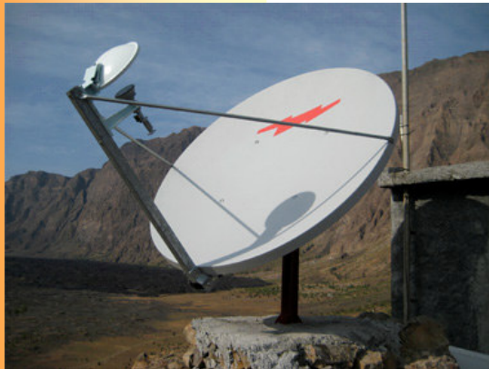
V-sat antenna set in Fogo.
